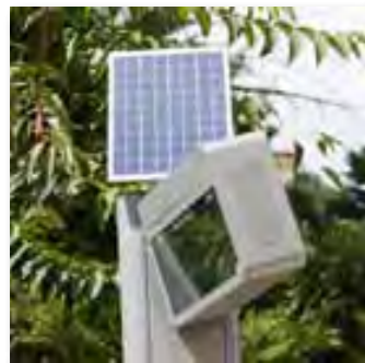
Panneaux solaires pour abris bus
