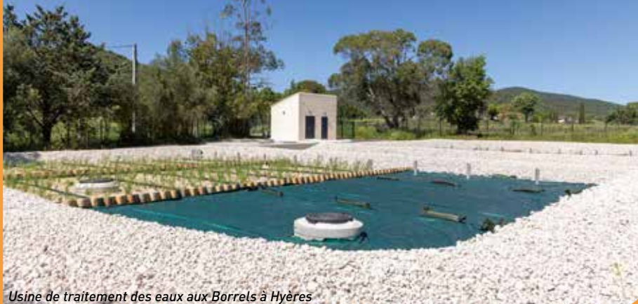
Usine de traitement des eaux aux Borrelles à Hyères
