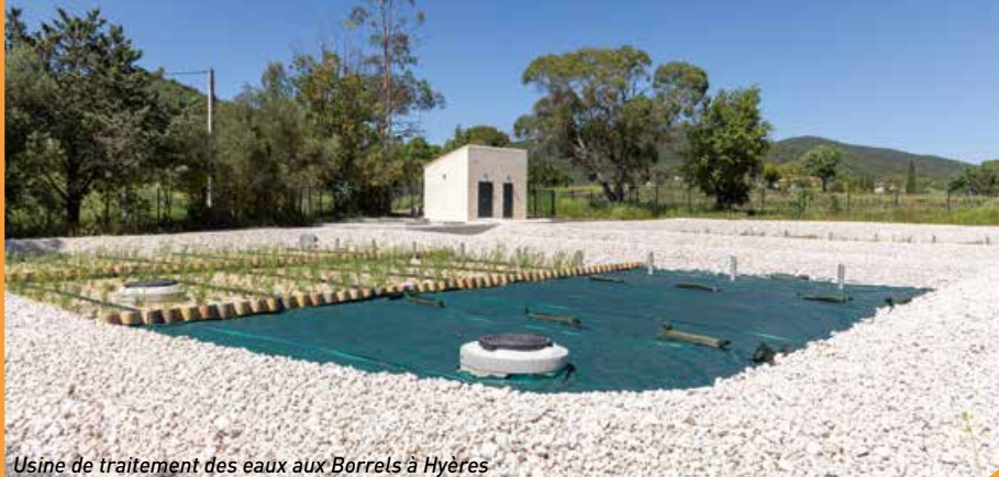
Usine de traitement des eaux aux Borrels à Hyères
